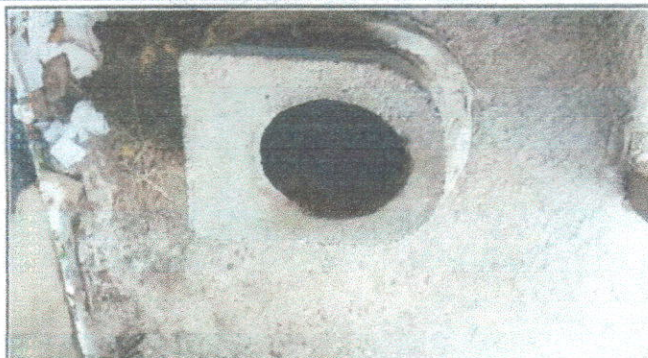
Foto 2: Se observa el baño en mal estado
