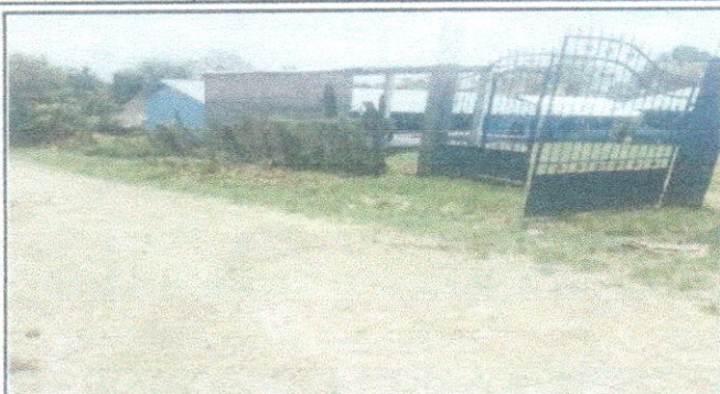
Foto 1: Se observa el cerco perimetral de la Escuela en mal estado
