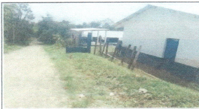
Foto 3: Se observa el cerco perimetral de la Escuela en mal estado
